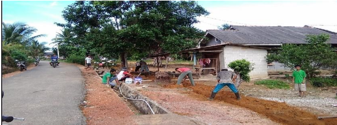
Kerjasama masyarakat pendatang dan masyarakat lokal membuat saluran air di lingkungan perumahan transmigrasi
