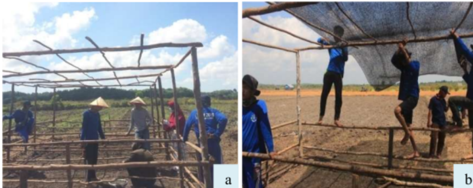
Gambar 39. Proses pembuatan kolam lele, (a) Pembuatan kerangka kolam lele, (b) Pemasangan komponen kolam ikan lele.
