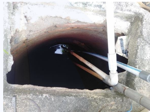
Gambar sumur rumah Bapak Hendri
