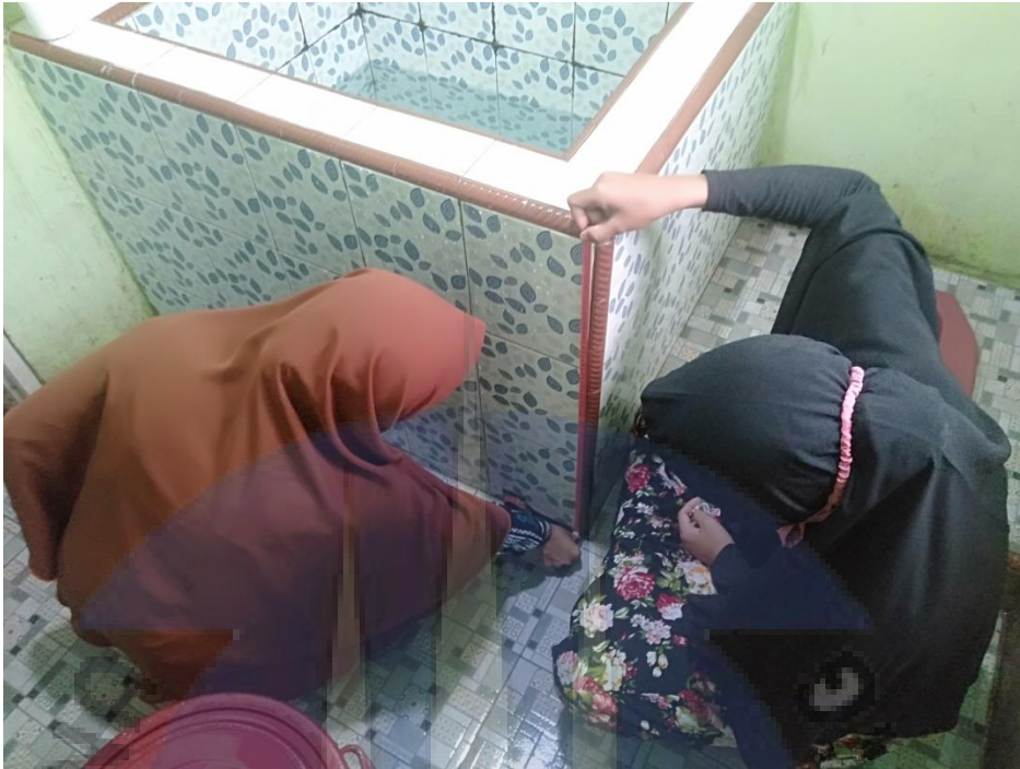
Jenis Bak Penampungan Air yang digunakan
