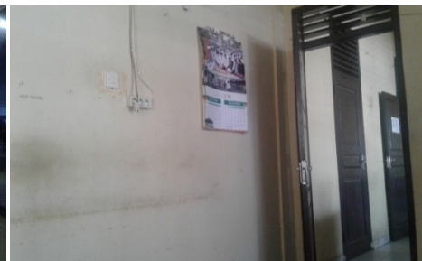
Gambar I.2 Cat dinding tempat bekerja sudah kusam atau berubah.
